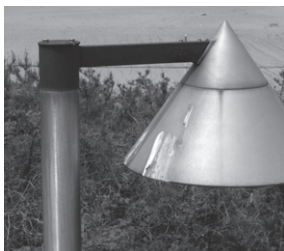
塩害で腐食した器具の例
