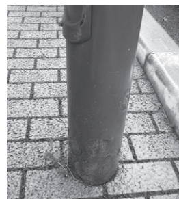
ポールの腐食した例
