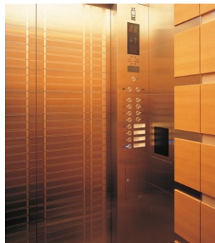
エレベーター内のカードリーダー
