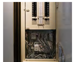
多回路エネルギーモニタが設置されている分電盤
