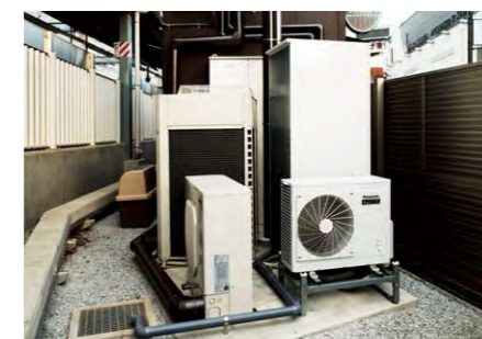
高効率空調設備と並んで設置されている420Lエコキュートは災害時には帰宅困難者に温かい湯を提供する
