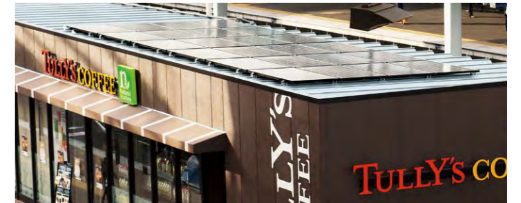
屋上に設置された10kWの太陽電池モジュール
