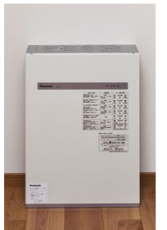
屋内に設置されたリチウムイオン蓄電池
