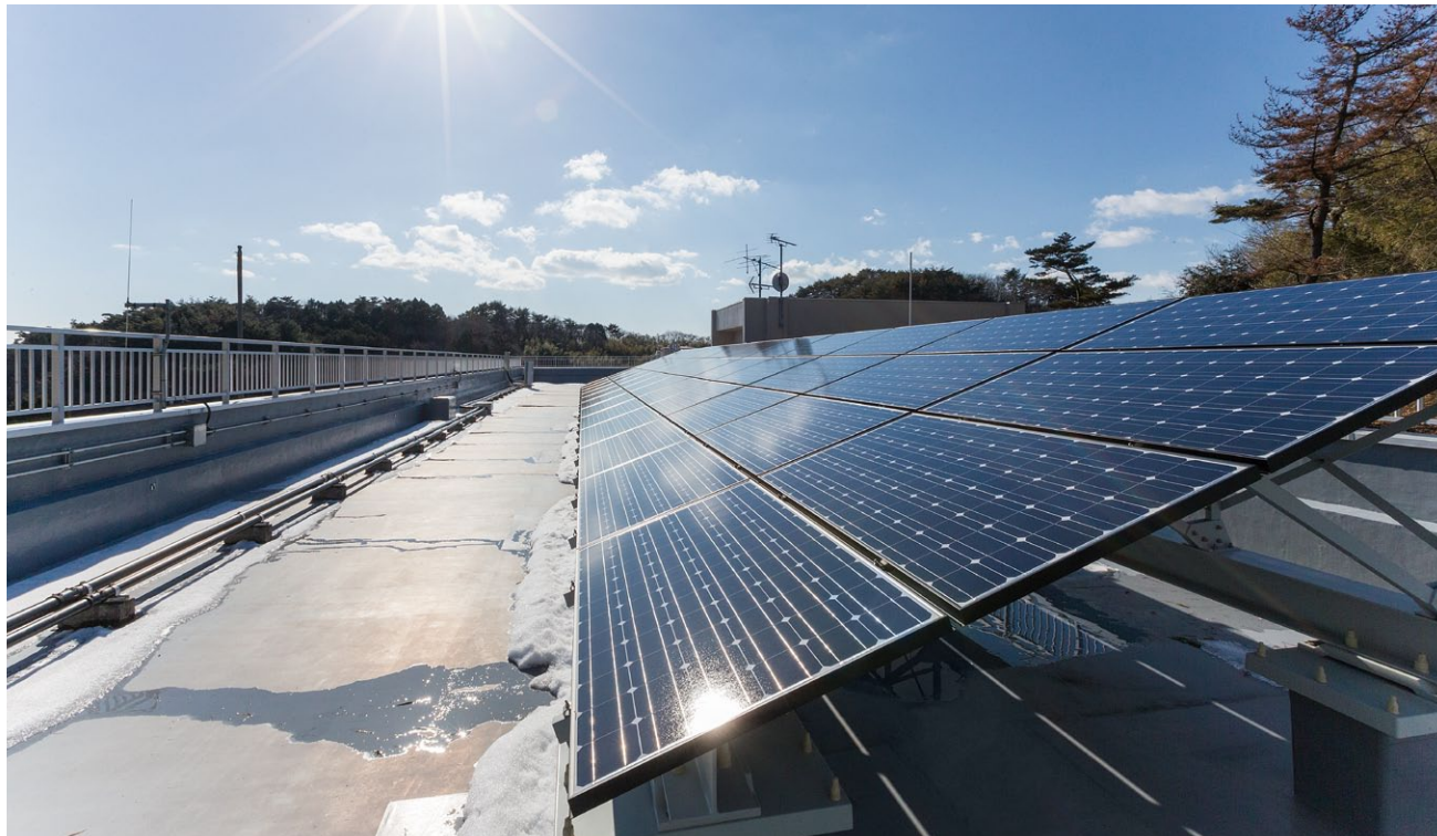
校舎屋上に設置された太陽電池モジュール
