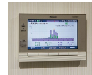
屋内に設置されたモニター画面で、発電量を確認
