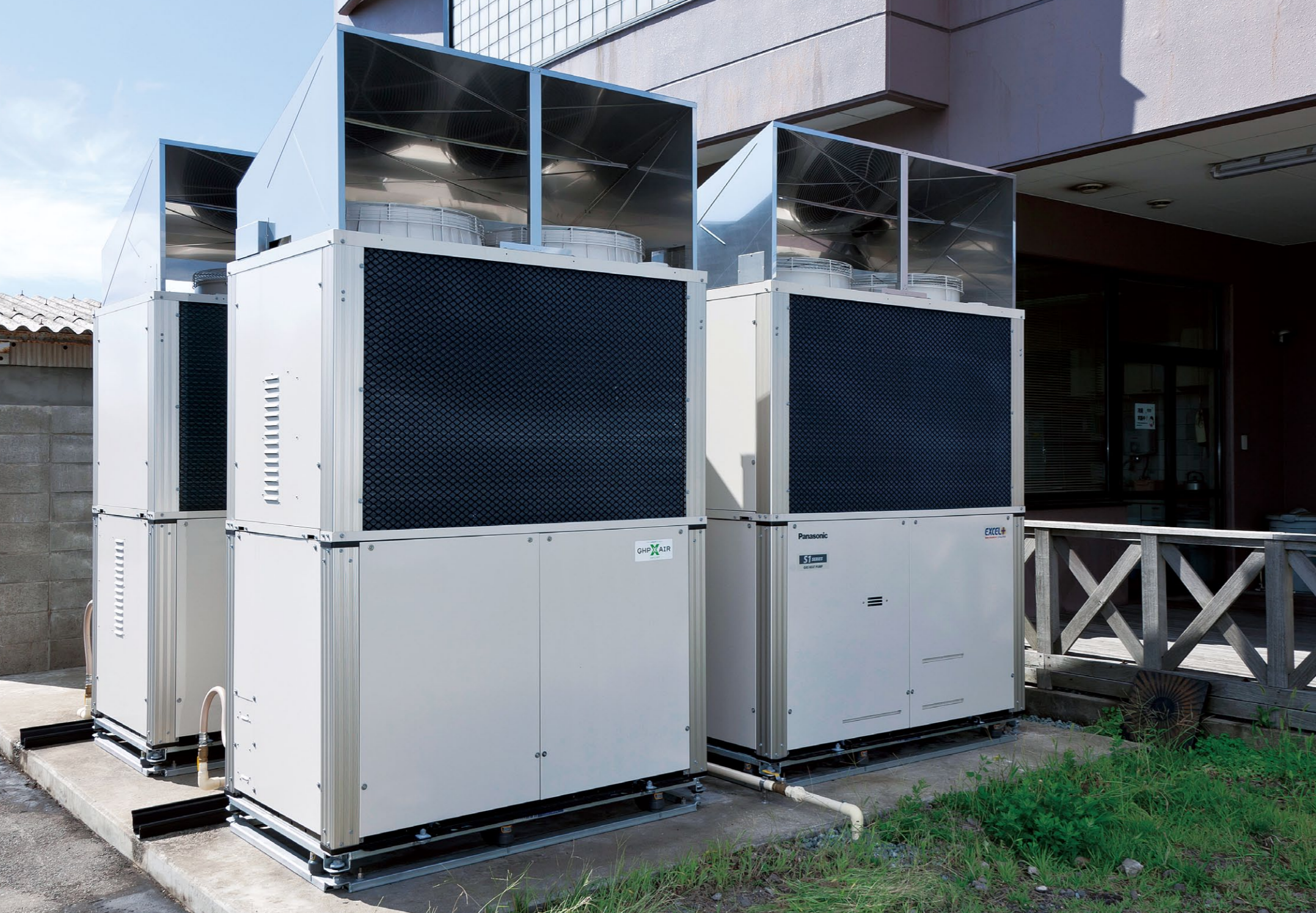
停電時に発電することで、照明・空調に電力を供給するエクセルプラス(右端)と3機のGHP
