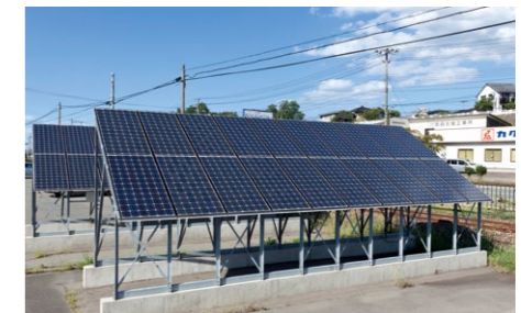
同時に設置された太陽光発電システム
