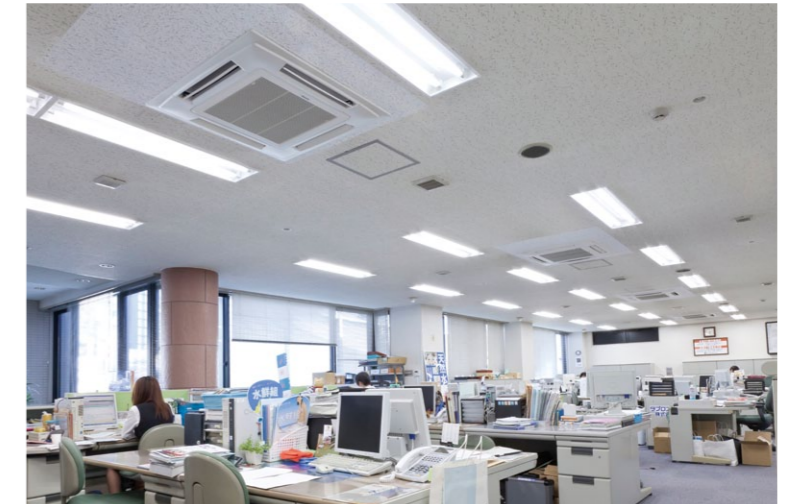
停電時には一部照明と空調が稼働する執務室
