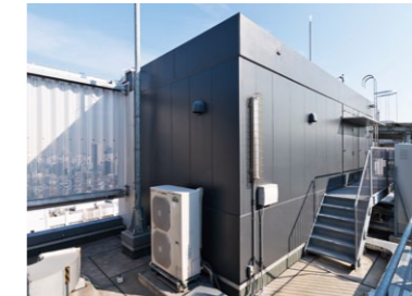
中央教育研究棟のパッケージエアコン
