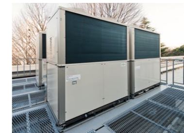
北1号館屋上のGHP室外機
