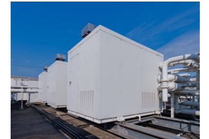
西5号館屋上のナチュラルチラー(吸収式冷凍機) ※P-AIMSとの接続を検討中
