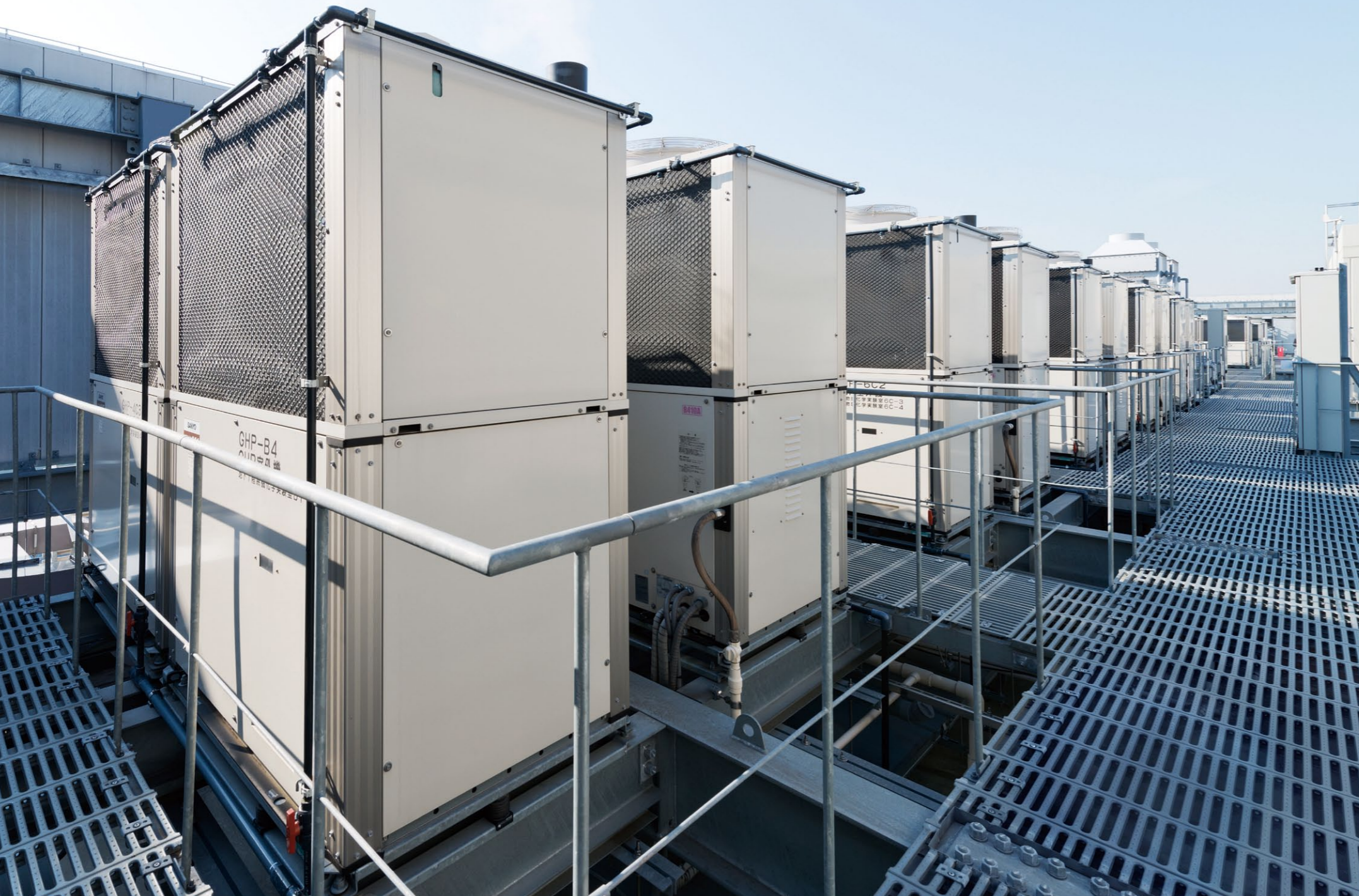
中央教育研究棟の屋上に設置されたGHP室外機
