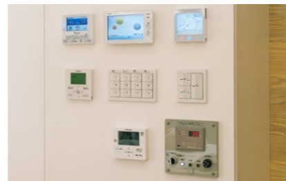
統合的HEMSモニタなどが設置された壁面
