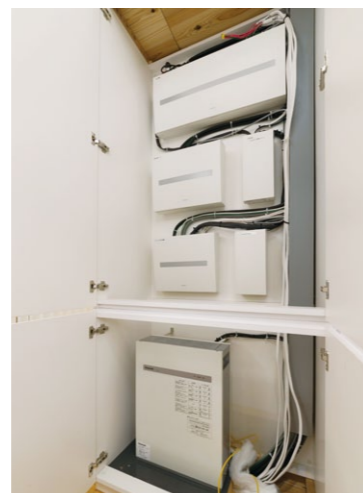
パネル内に収容された住宅分電盤と蓄電池
