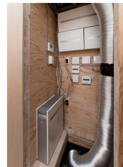
EPSIに設置された住宅分電盤や蓄電池など
