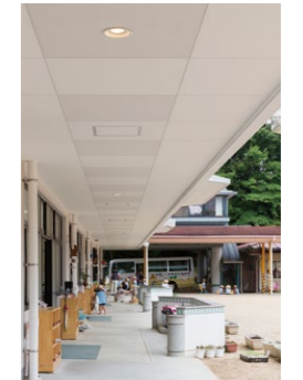
軒下に設置された電球色のLEDダウンライト
