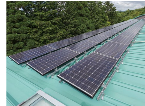
屋根上に設置された太陽電池モジュール HIT238A
