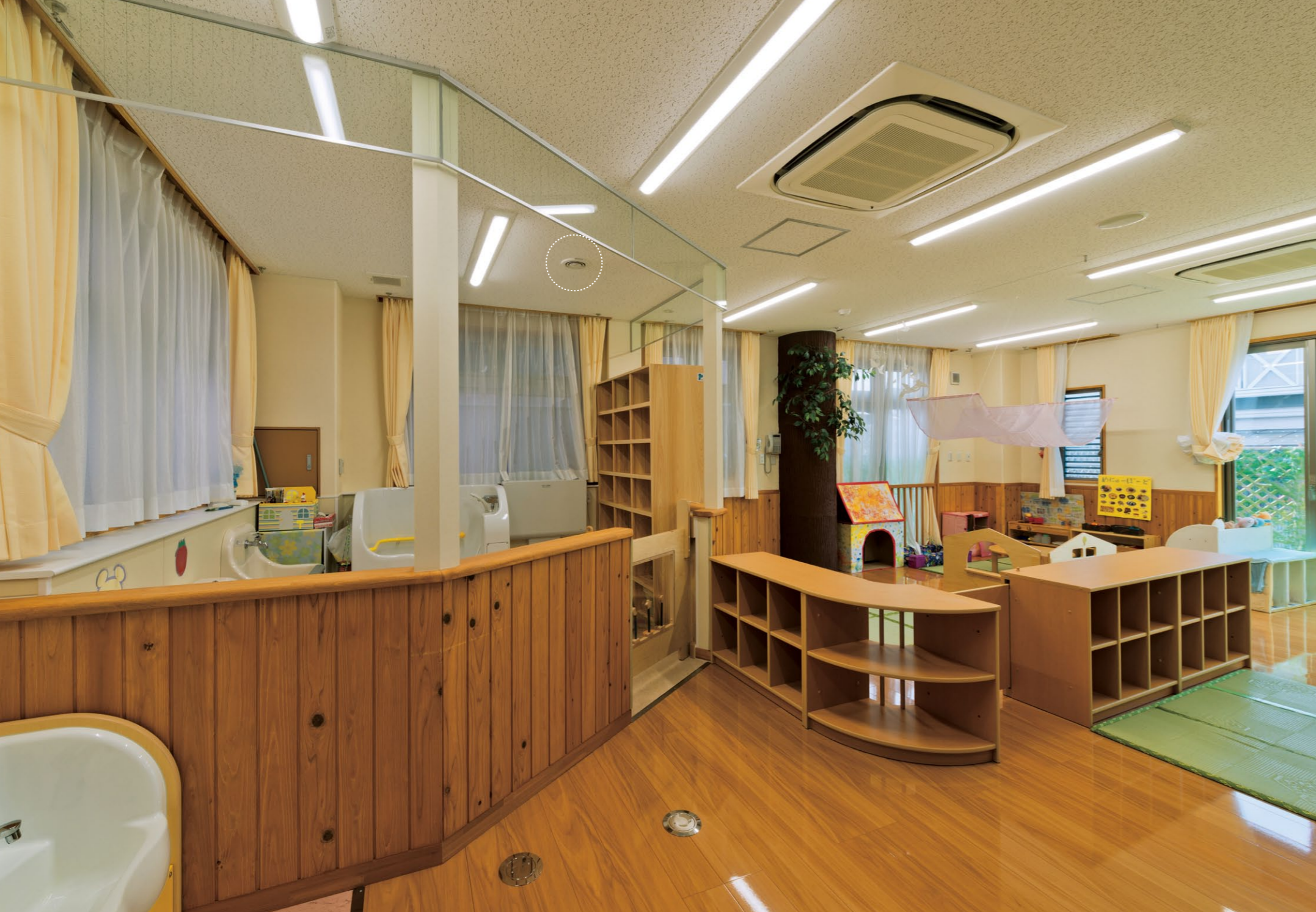
トイレと保育室が一体となった乳児室では、ニオイ対策のためエアイーが採用されている
