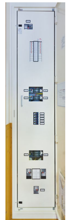
メンテナンスも考慮した商用電源/蓄電池切替分電盤
