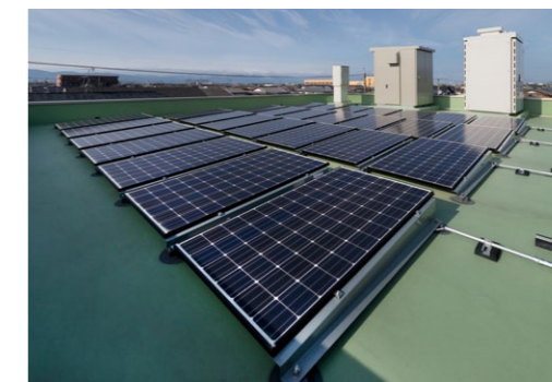
屋上に設置された太陽電池モジュール HIT245aと15kWh蓄電システム (右上)
