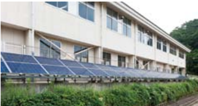
市立第一中学校では、テニスコートの脇に太陽光パネルが設置されている
