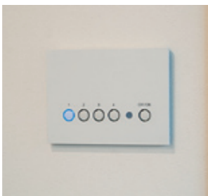
LDKに設置されたリビングライコン。好みの照明に合わせたシーン切り替えを体感できる。
