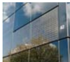
窓と一体となった太陽光パネル (ISEゼロエミッションオフィス)
