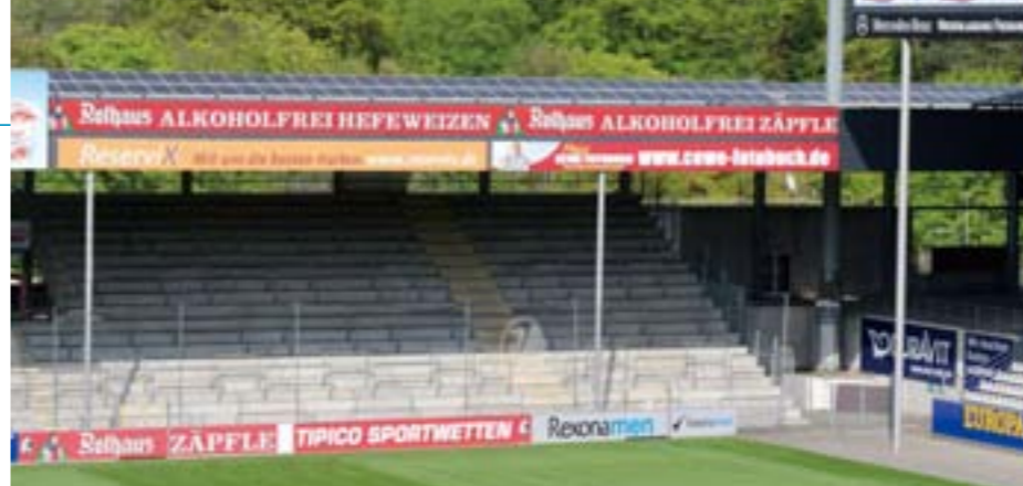
地域電力創出プログラムにより、SCフライブルクサッカー場の屋上には市民が購入した太陽光パネルが並ぶ
