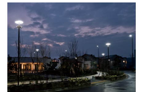
人が近付くと照度を上げる、省エネに配慮したLED街路灯
