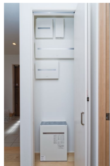
分電盤や蓄電池を収納するスペースも設置
