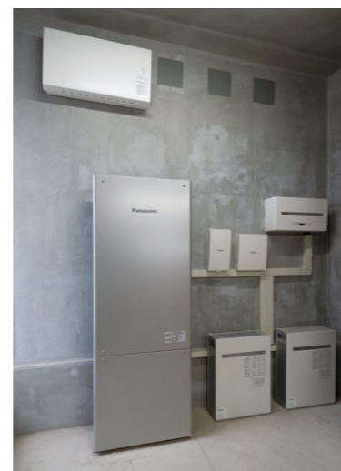
防災倉庫に設置された蓄電池と創蓄連携システム
