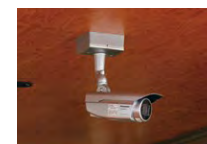
テラスの監視カメラ
