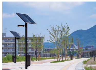
南北遊歩道のソーラー街路灯
