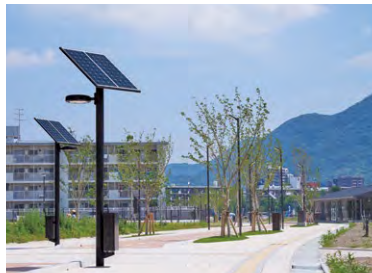
南北遊歩道のソーラー街路灯
