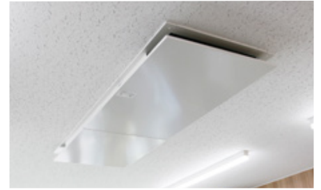
2階オフィスに設置された熱交換気
