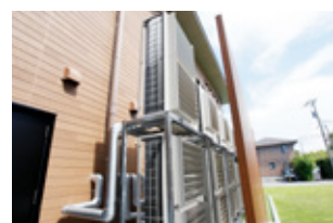
室外機には風向ガイドを設置。
