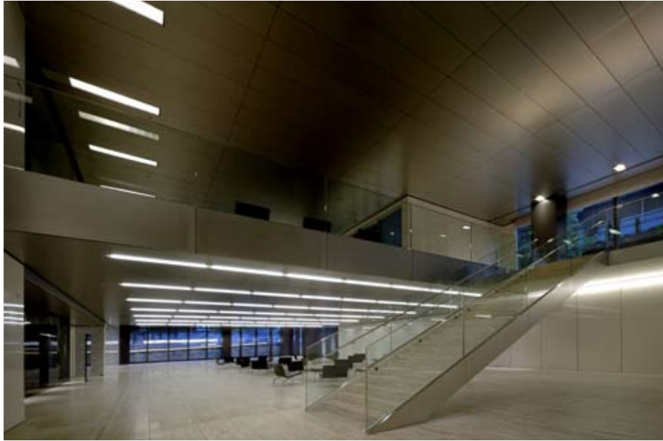
「TORANOMON TOWERS」オフィス棟地下1階エントランスホール。地下1階天井に使われているのは、TL5のスリムな蛍光管を光源とし、コンパクトな反射板による高効率な照明。吹き抜け部の天井の仕上げはステンレス複合パネルで、自然光を反射することにより自然な明るさをつくり出す。*
