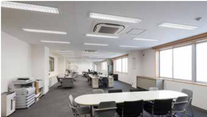
事務所棟(上)と工場棟2階は、「直管形LEDランプ搭載ベースライト 起動方式LEタイプ」が明るく照らす
