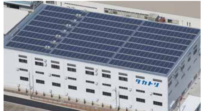
約3,300㎡の屋上一面に設置された太陽光パネル。竣工時点で奈良県下最大規模の太陽光発電施設となった
