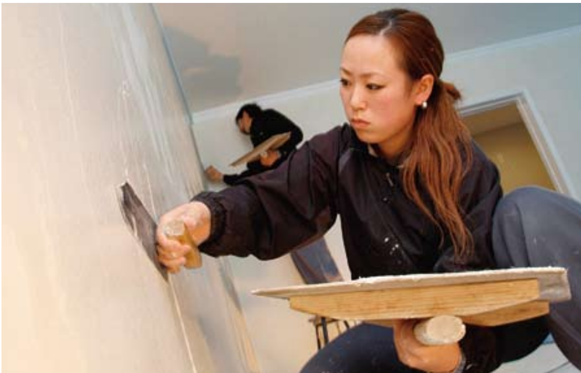
素材の乾き具合を見ながら時間を置かず塗り重ね、層の厚さを均一にする。（新潟市の戸建住宅の漆喰仕上げの現場で）
