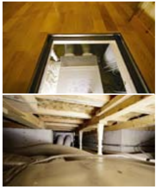
1階の廊下の床下に設置された気調システムの室内機(写真上)。床下は70cmの高さがあり、メンテナンスのしやすさにも配慮(写真下)。
