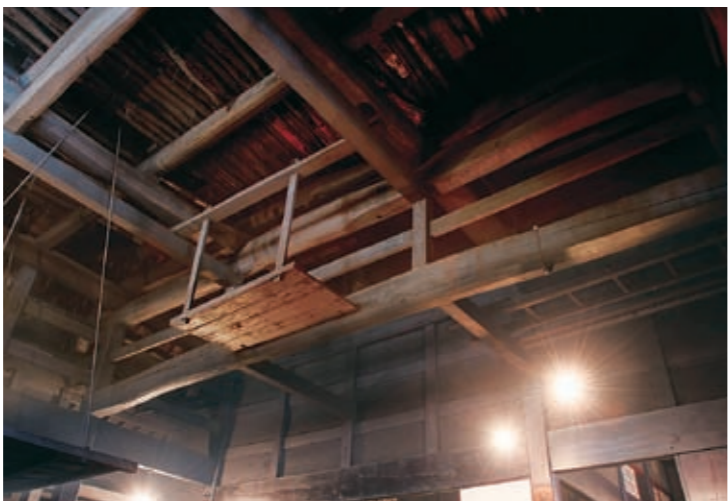
炉地(土間)には、大屋根を支えるため梁に束を組み重ねる二重梁が用いられている。
