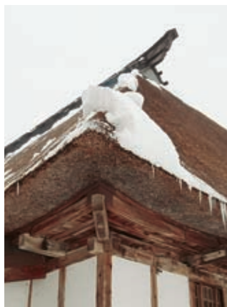
屋根はできるだけ雪が積もらないように45度近い傾斜にしている。
