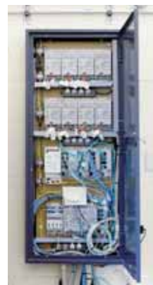
機械室のDC配電盤とライフィニティ制御盤
