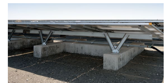
埋立地の地下から発生するガスが滞留しないように設計されたH型基礎
