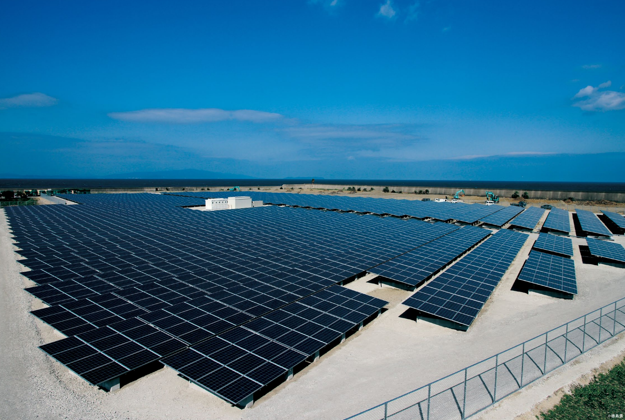
240W多結晶太陽電池モジュール8,784枚が設置された総出力2MWのマリンピア沖洲太陽光発電所
