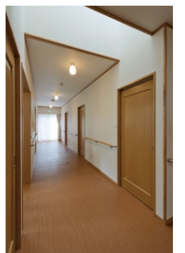
廊下に設置されたLED照明
