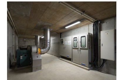
堆肥舎施設で発生するアンモニアなどを含んだ空気を脱臭ロックウール槽に送るポンプ施設
