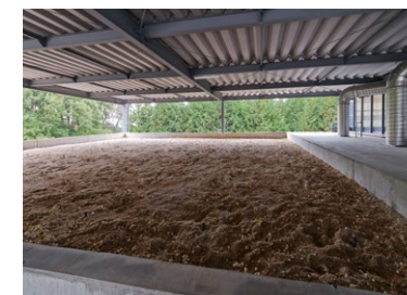
微生物によりアンモニアを分解するロックウール槽
