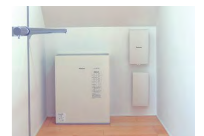
階段下に収納されたリチウムイオン蓄電池
