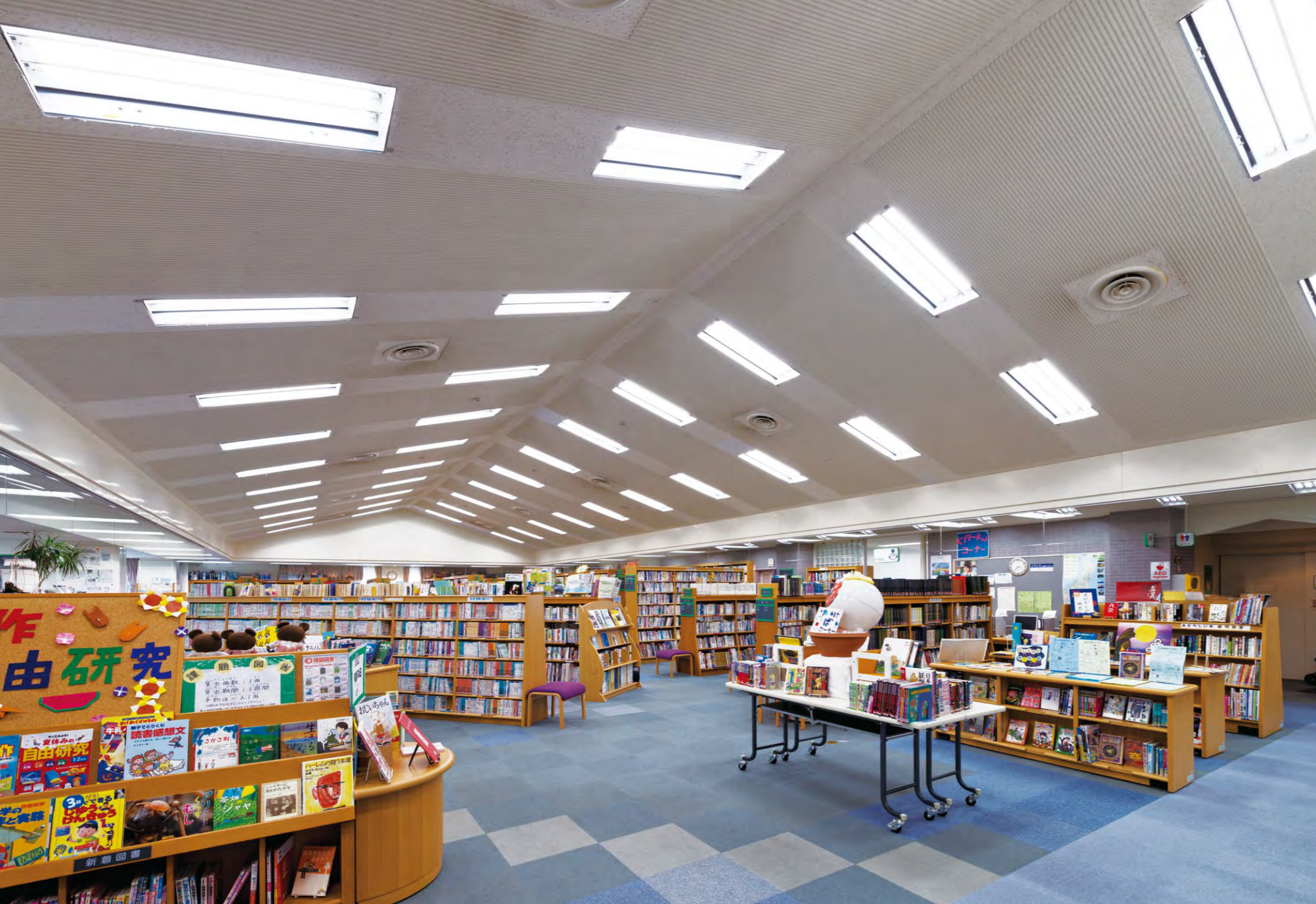
消費電力の少ないLED器具に一新された図書館の照明設備
