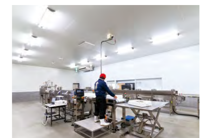
放射線測定室の直管LED照明器具
