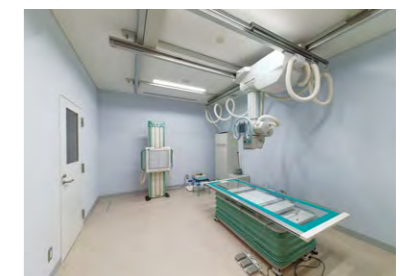
X線撮影機器が設置された室内
