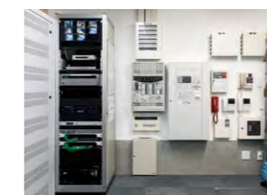
事務室に設置されたネットワークカメラ、非常用放送設備、防災受信機(左から)
