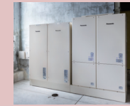
リチウムイオン蓄電システム 22.4kWh 2台
