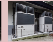
ガスヒートポンプエアコン 20馬力 6台
