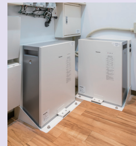
リチウムイオン蓄電池
