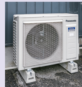
ルームエアコン室外機 (事務所用)
