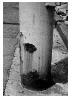
地際部 犬の尿により錆びた状態
