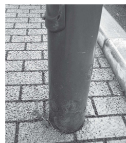
ポールの腐食した例
