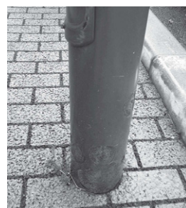
ポールの腐食した例
