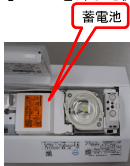
【カバーを外した状態】
