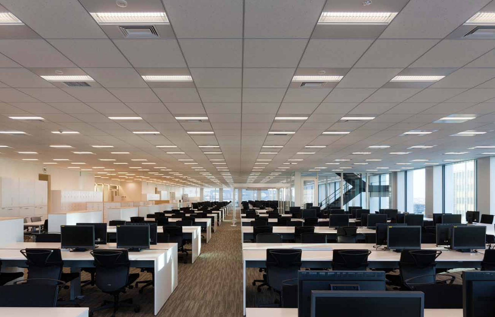
事務所。温白色で机上500lxで運用、デジタル個別制御の導入できめ細やかなタスクアンビエント照明と省エネを実現している。
