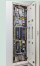
電灯盤内に設置された多回路エネルギーモニター
