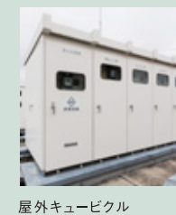
屋外キュービクル
