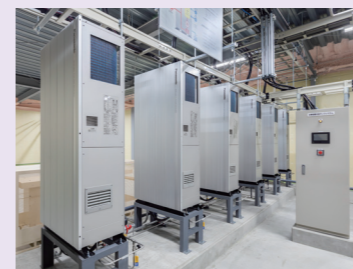
純水素型燃料電池
