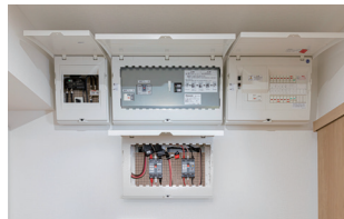
上段左から:電力検出ユニット、電力切替ユニット、スマートコスモ、下段:漏電ブレーカ
