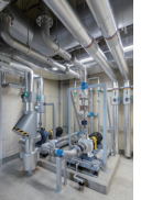
空調ポンプ設備
