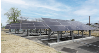
太陽光発電システム
