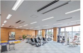
LEDベースライト・空調室内機
