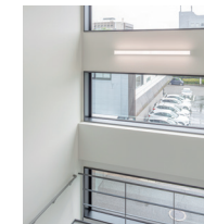
階段通路誘導灯
