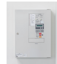
自動火災報知設備
