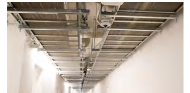
INIADの校舎内には、照度センサ、人感センサ、温度・湿度・気圧センサなどのセンサ類が、学内ネットワークを通じて照明やエレベーター、空調、インテリジェントドアなどに連携。新しいデバイスの増設がスムーズにできるよう、廊下には天井板が張られていない。(画像提供:INIAD)
