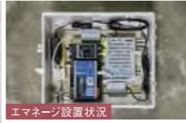
エマネージ設置状況
