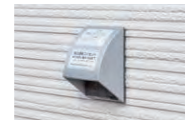
停電の際に太陽光発電で発電した電気を使用できる自立運転コンセント。災害時に地域の方に使っていただけるようにと設置されました。
