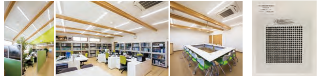
執務エリアと会議室には明るさを検知して自動的に省エネするセパレートセルコンと、デマンド連動機能付ライコンを併用。タイムスケジュール運転で自動調光しながら、ピーク時にはエマネージにより空調運転制御と併せて調光制御が可能です。
