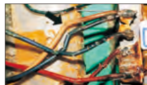
劣化したリード線
