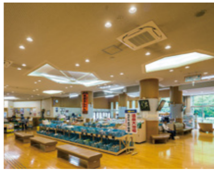
青井岳荘:LED照明と高効率空調、エマネージの導入により年間CO 2 排出量130.7tを削減。
