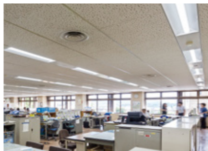
本庁舎執務室:窓側2列は無線調光タイプのLED照明(PiPit調光)を導入。日中は照度を落としてさらなる省エネを実現。
