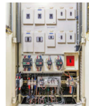
多回路エネルギーモニターで回路を計測。
