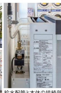
給水配管と本体の接続部
