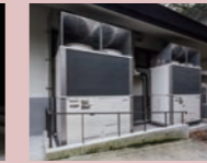
ガスヒートポンプエアコン 20馬力 6台
