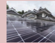
太陽光発電システム 20kW
