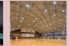
LED高天井用照明器具 291W 48台
