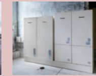
リチウムイオン蓄電システム 22.4kWh 2台
